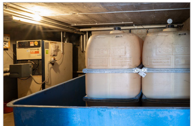
Heizung / Tankraum (unter Haus Nord)
